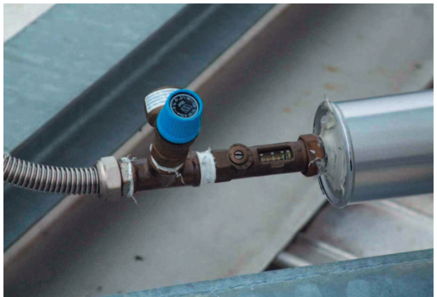
Bild 6: Nicht geeignet für den Einbau in unmittelbarer Kollektornähe: Sicherheitsventil und Durchflussmengenbegrenzer ohne ausreichende thermische Beständigkeit für die gewählte Einbauposition.
