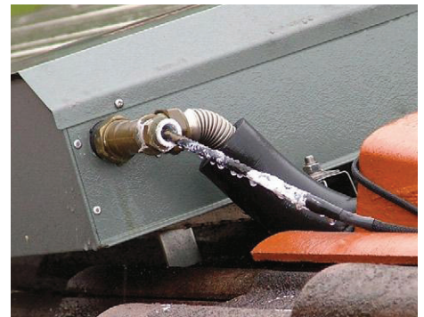
Fühlerkabel nicht befestigt
