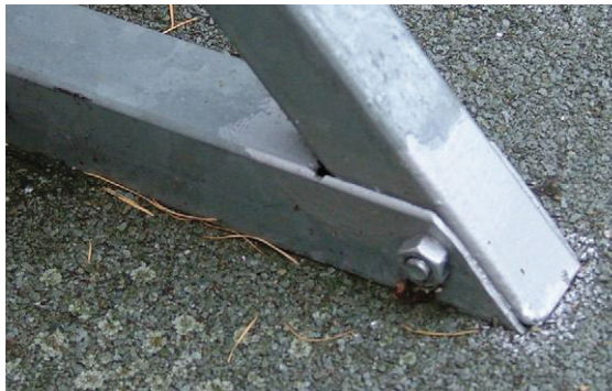
Korrosionsschutz ist regelmäßig zu überprüfen
